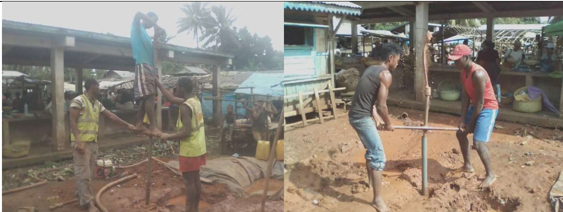
Photo 01 : Les équipes en plein construction de forage au marché de Marofarihy centre
